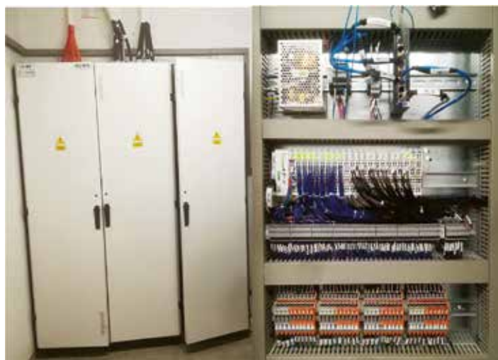
Rys. 8. Główna szafa zasilająca wraz z głównym sterownikiem PLC systemu
