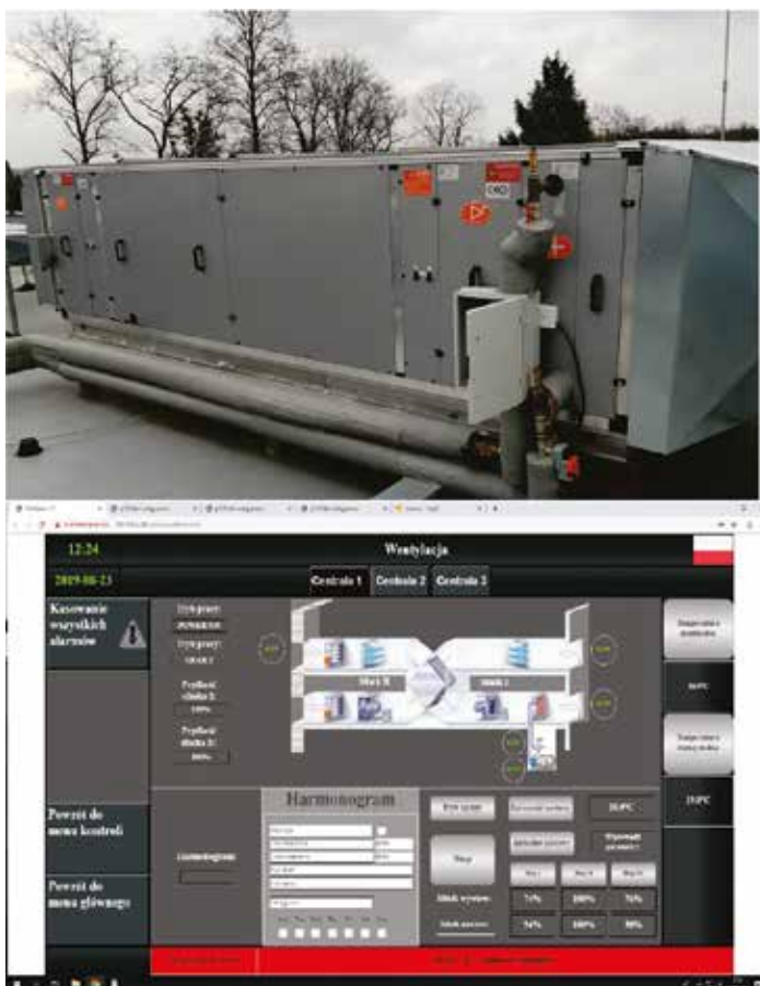
Rys. 16. Widok centrali wentylacyjnej na dachu budynku szkoły (a) i graficznie w systemie BMS (b)
