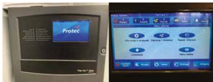
Rys. 6. Instalacja systemu PPOZ oraz SWIN
