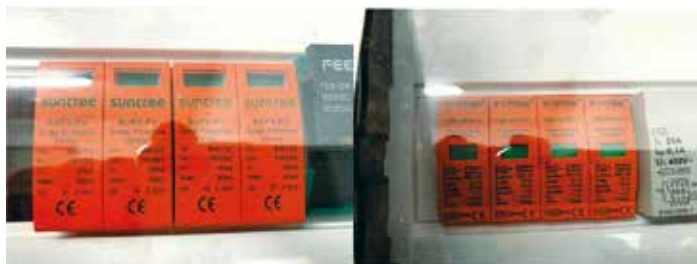
Rys. 7. Urządzenia ochronne zainstalowane w instalacji elektrycznej budynku
