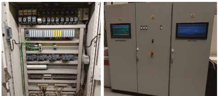
Rys. 4. Widok szafy sterowniczej malarni w lakierni proszkowej (a) z ekranami HMI (b) do sterowania pracą linii oraz do monitorowania pracy linii w SCADA
