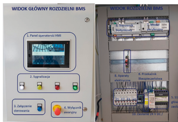
↑ Rys. 7. Zabudowa urządzeń automatyki budynkowej firmy Siemens w szafie sterowniczej, na przykładzie Inteligentnego Piętra Katedry Aparatów Elektrycznych PŁ [16]
