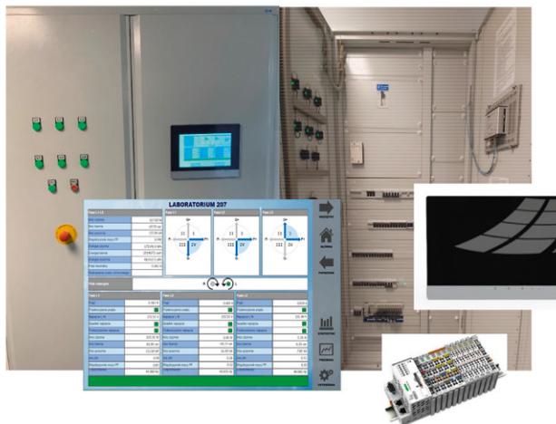
↑ Rys. 12. Rozdzielnia zasilająca z pomiarem i monitorowaniem jakości i zużycia energii elektrycznej w Katedrze [16, 17]
