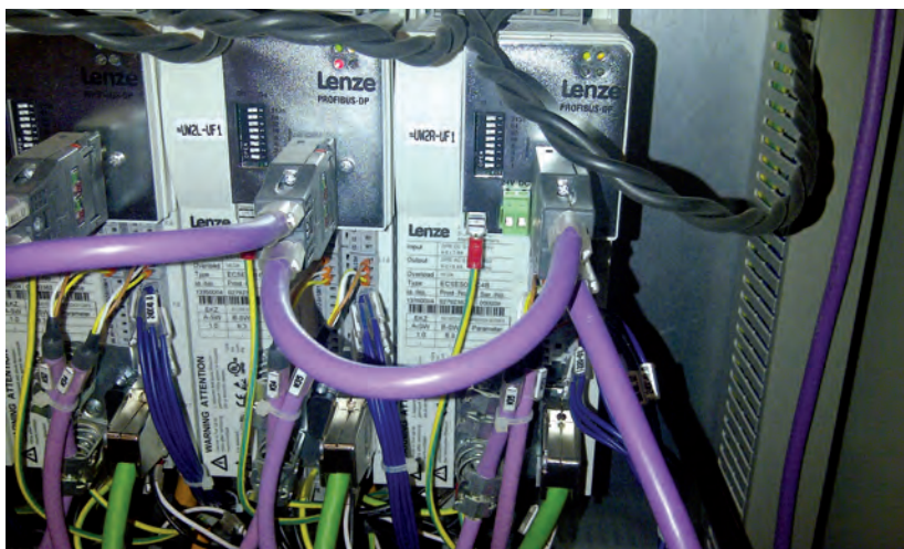
Fot. 2. Przykład instalacji sieci przemysłowych
