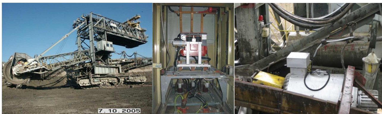
Rys. 1 a) Widok koparki SRs 1200/5; b) Widok pola nr5 rozdzielni 6kV; c) Widok silnika 320 kW T1
