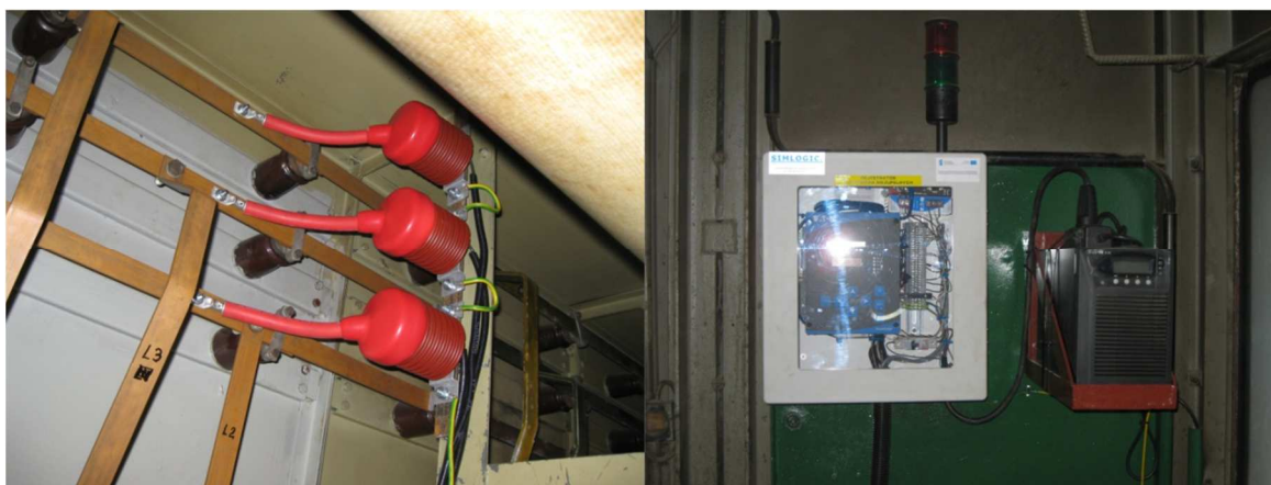
Rys. 5 a) Kondensatory sprzęgające w p.5 rozdz. 6kV; b) Zabudowany system monitoringu InsulGard Zainstalowano czujniki do pomiaru WNZ:
