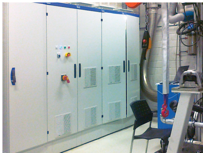
Szafa napędowa w obudowie typu xEnergy w jednym z pomieszczeń hamowni.
